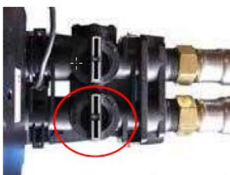
Bypass in bedrijf (Gesloten)
